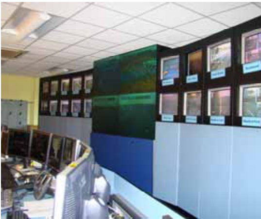
Centre de contrôle
